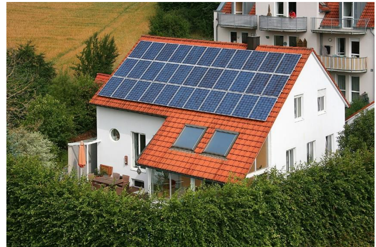
Photovoltaik Anlage auf Einfamilienhaus
